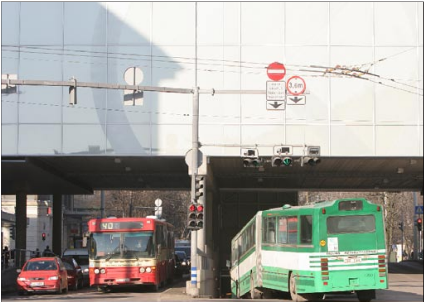
Bussid kannavad talvel tänavatelt Viru keskuse allmaaterminali soolast sulavett, tekitades sellega betoonkonstruktsioonidele suure kloriidikoormuse.
