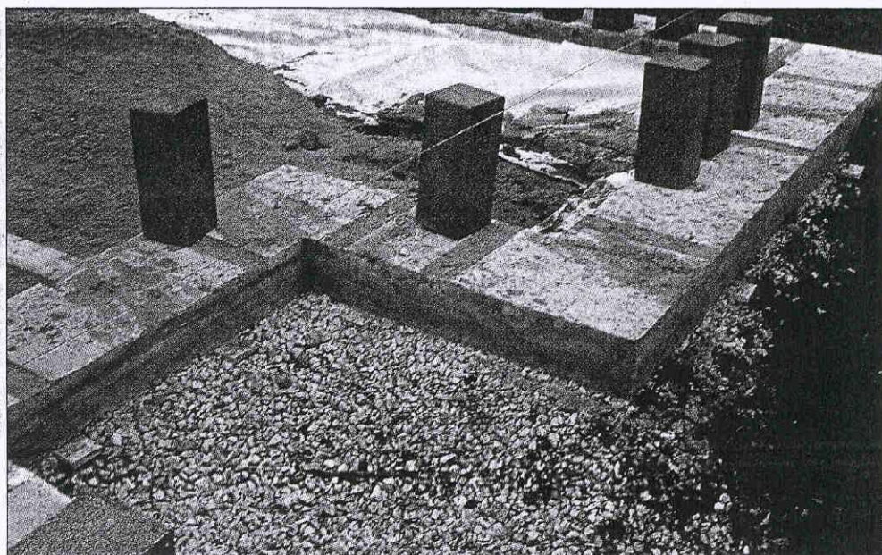
Если фундамент нового дома изготовлен с дефектами, то устранить их после того как дом уже готов будет крайне сложно.
