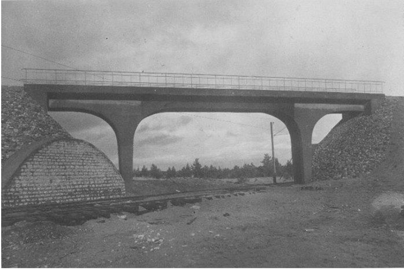
Peeter Suure Merkindluse raudtee Rahumäe viadukt pärast rekonstrueerimist. Foto R. Kalda erakogust via www.raudtee.eu
