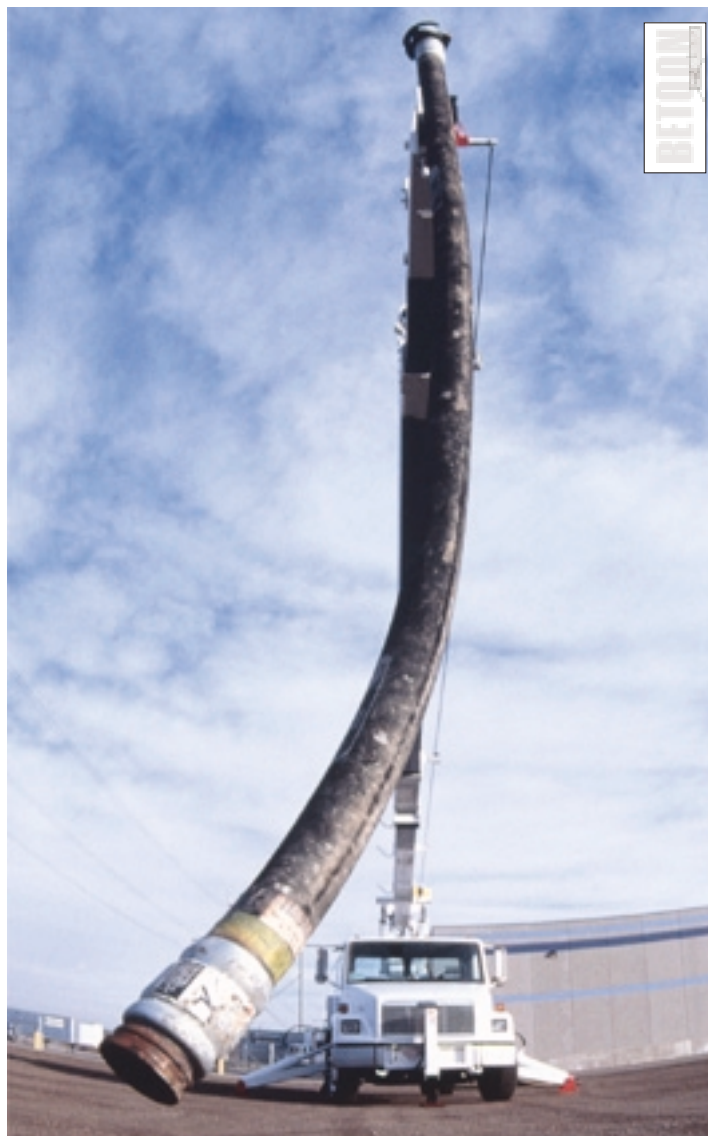
Millise õhu hulgaga on betoonisegu veel pumbatav, sõltub segu töödeldavusest, torustiku pikkusest ja jämedusest, segu pumpamise suunast.
